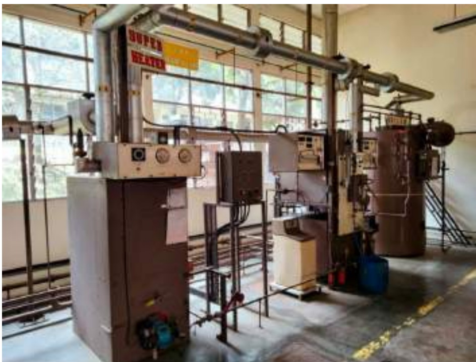
Gambar F.5 Fasilitas pelatihan operator boiler
